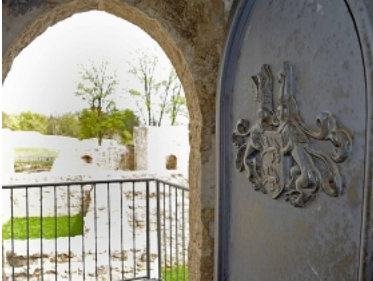
Die massive Tür am Bergfried bedarf dringend frischer Farbe: Der Rost setzt dem mächtigen Trumm gehörig zu.
