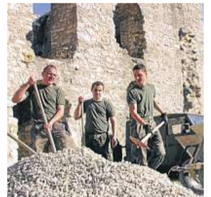
Soldaten aus Hemau, später aus Regensburg, halfen bei den Bauarbeiten oder entfernten Gebüsch.
